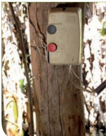
Instalação elétrica mal feita
