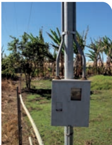
Instalação elétrica bem feita
