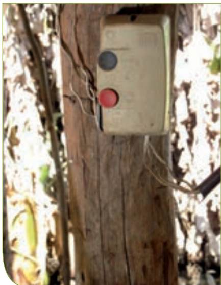
Instalação elétrica mal feita
