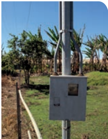
Instalação elétrica bem feita
