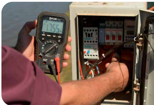
Aferição da carga de energia do aerador
