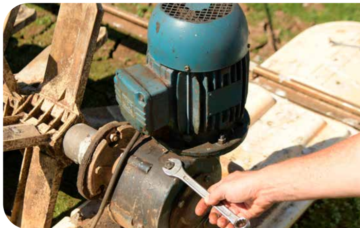
Conjunto motor redutor indicando o local para a retirada do óleo
